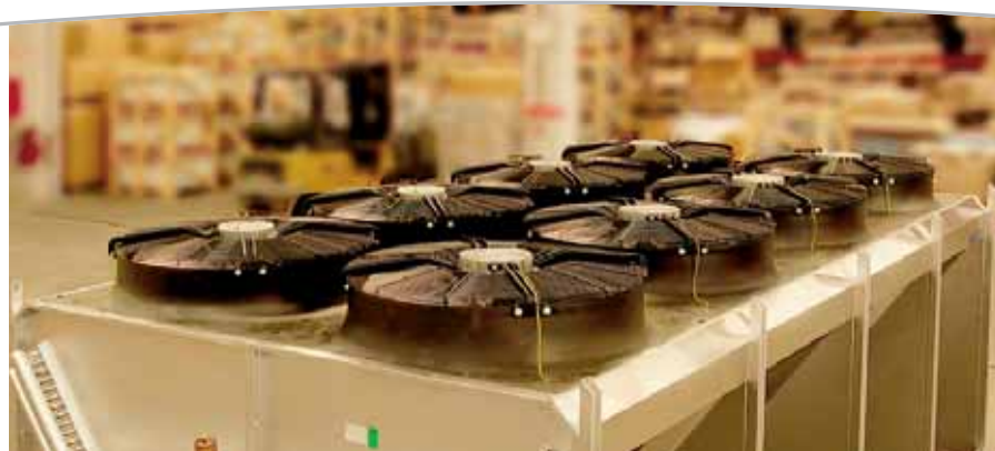
Il controllo accurato delle ventole permette di risparmiare energia, e mantiene il rumore ai minimi livelli.
